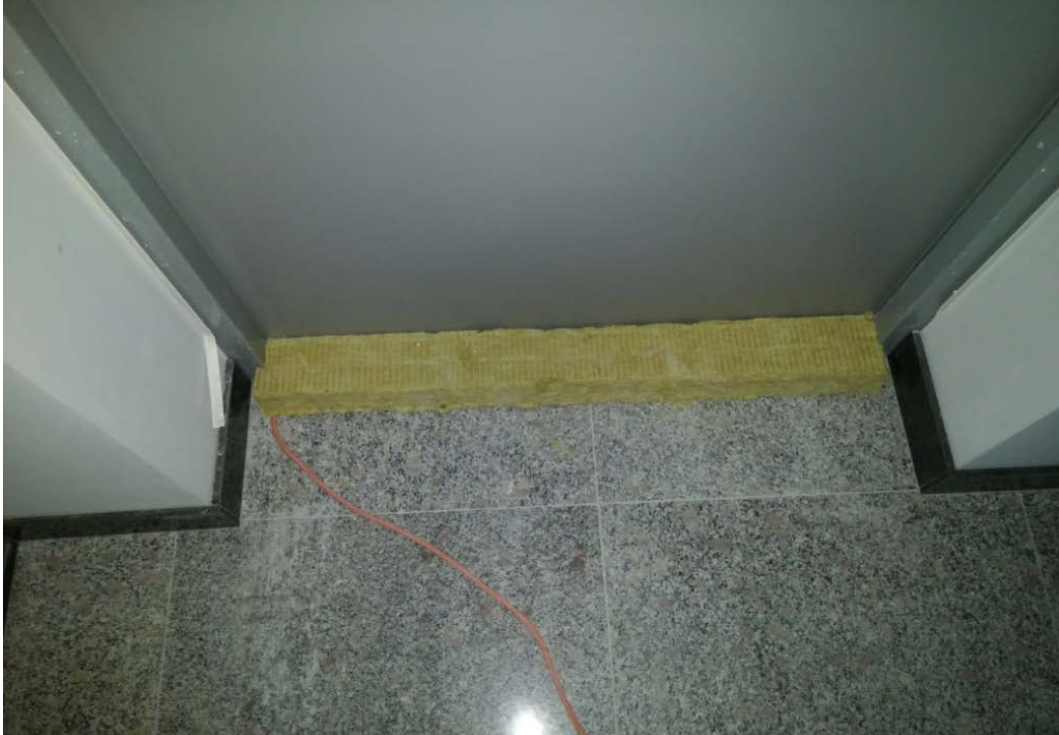
Fot. 1 Prowizoryczne uszczelnienie dolnej części skrzydła drzwiowego za pomocą płyt z twardej wełny mineralnej w celu ograniczenia przenikania drogą przez korytarz energii akustycznej
